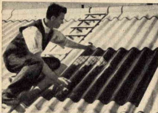
Fig. 10 - Per migliorare l'illuminazione interna di edifici già da tempo costruiti, senza dover apportare alcuna modifica alle strutture portanti, sarà possibile procedere alla sostituzione di settori di copertura non trasparenti con lastre di laminato plastico.
